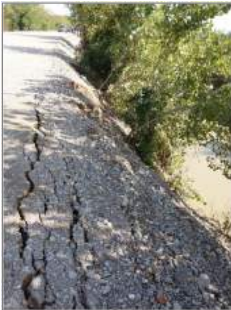
Εικόνα 14: Ευάλωτο ανάχωμα νότια της πόλης της Καρδίτσας
